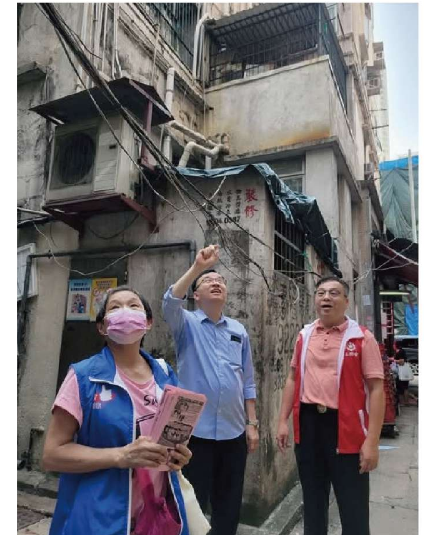
舊區「三無大廈」及後巷有不少安全隱患，例如電線亂纏，易生危險。
