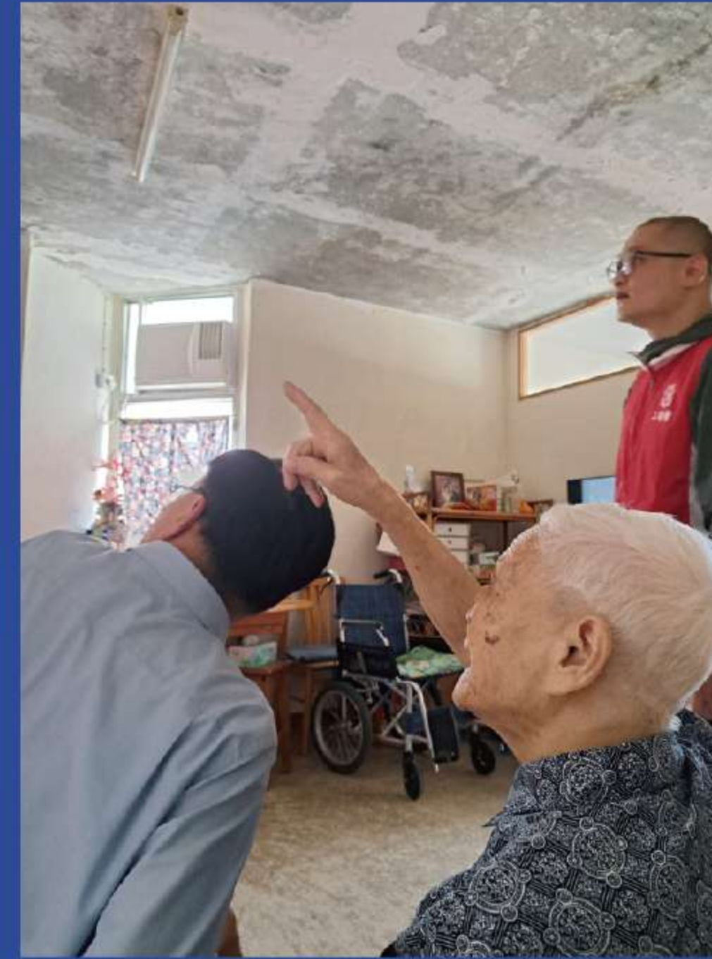
■ 家訪橫頭磡邨宏偉樓頂層長者住戶，其單位滲水問題嚴重，經反映後已妥善維修
