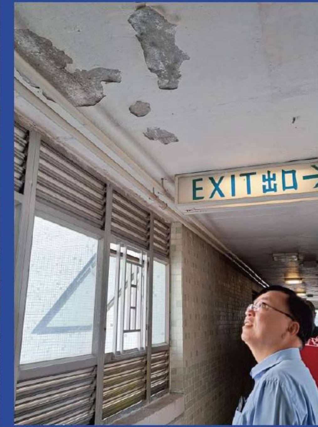
■ 除單位內，公共範圍亦因滲水導致天花剝落
